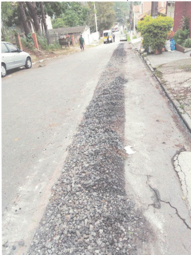
Ficando o empreendimento, apto ao efetivo lançamento dos efluentes de esgoto.
